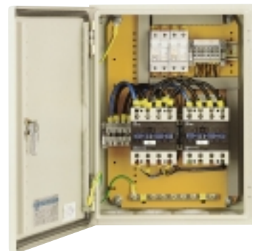
Caja de contactores
